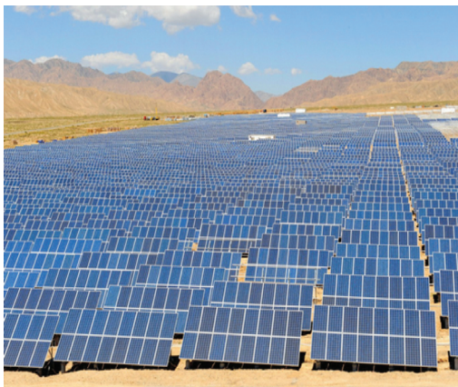
光伏组串和光伏阵列
